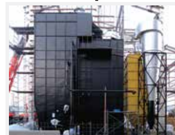
Japón 1 unidad de SB-130 Ahorro del diésel: 210,000 (L/año). Reducción emisiones de CO 2 : 575 Tn/año
